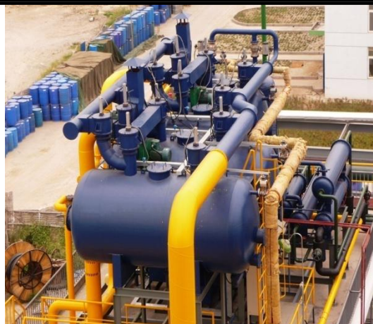
浙江上虞颖泰化工石油醚废气吸附回收装置
