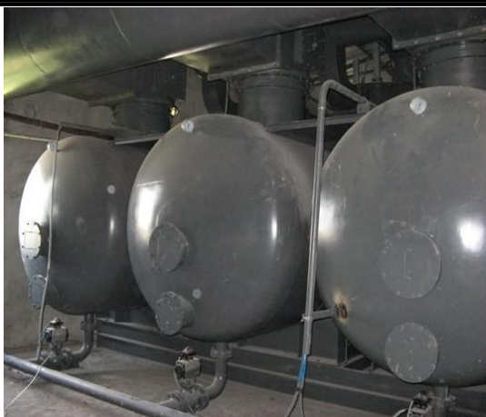
福建富鑫密封材料厂溶剂汽油吸附回收装置
