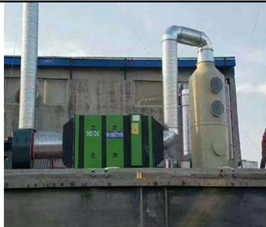
某企业 UV 光解废气处理装置
