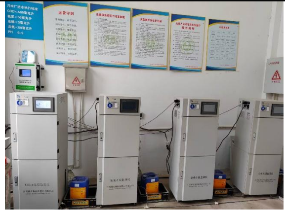
进水在线房内部
