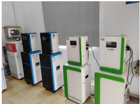
出水在线房内部
