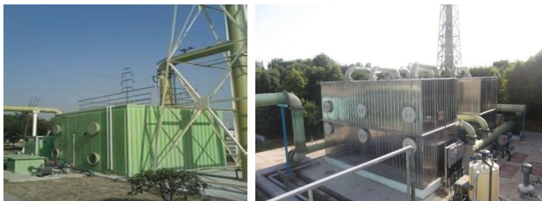
图 5-8 生物除臭装置实例。
